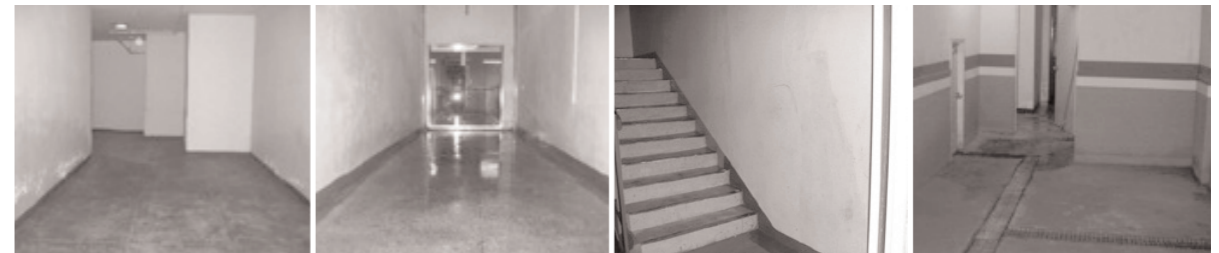
지하 엘리베이터 연결통로 결로(준공 2년차 단지)
